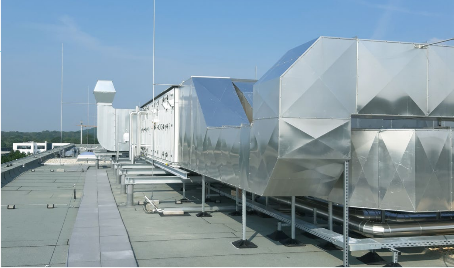
Der Neubau der Niederlassung Moers verfügt nicht nur über eine Erdwärmepumpe für die Klimatisierung, sondern auch über eine energiesparende Lüftungsanlage.
